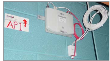
DPLN access point
